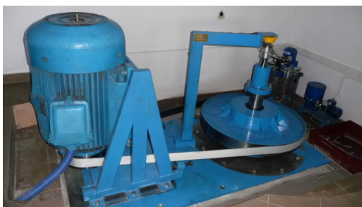
Rys. 2. Przykład małej elektrowni wodnej zbudowanej z wykorzystaniem maszyny indukcyjnej gdzie hydrogenerator jest napędzany turbiną wodną poprzez przekładnię pasową
